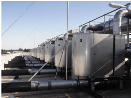
Slika 50: Filtri zraka (Foto: J. Jelen, februar 2013.)
